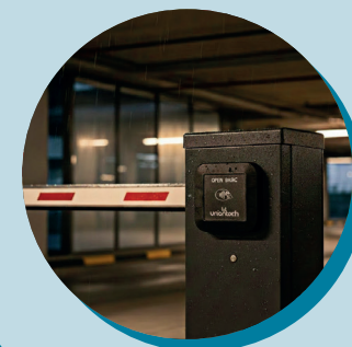
Sbarre di parcheggio / Varchi
